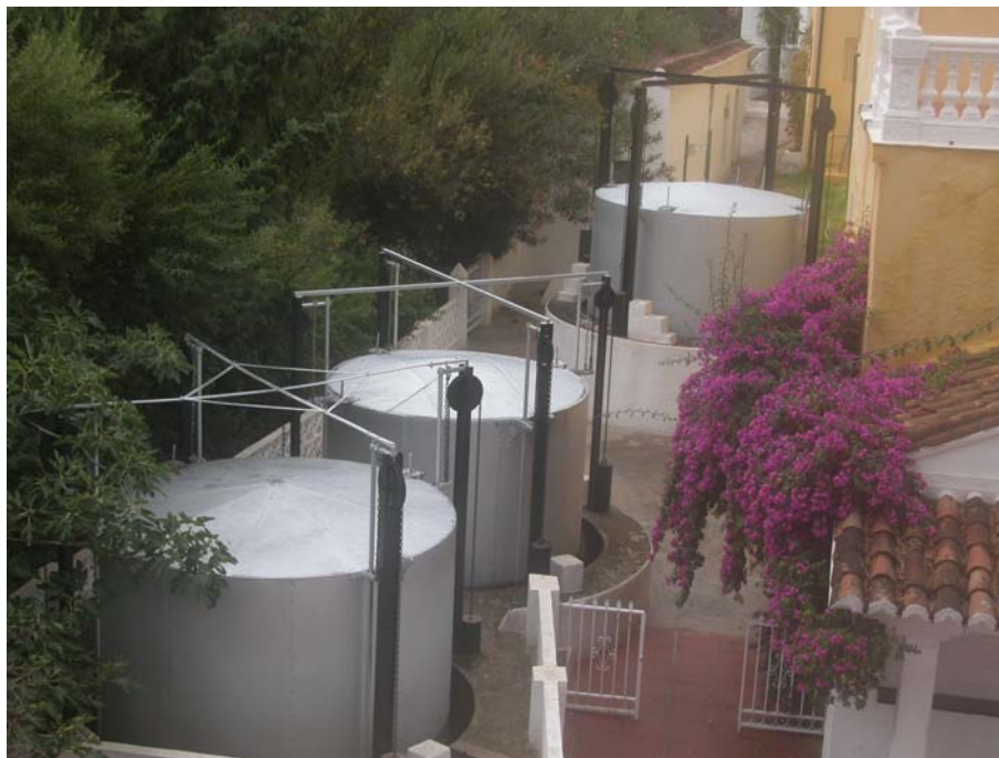
Instalaciones para captación y distribución del agua del manantial (IGME-DM-UMA, 2007).
